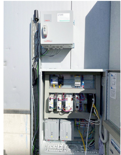
Lösungsbeispiel mit EinspeiserBox und kundeneigener Fernwirkstation.
